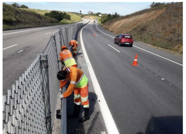
Figura 112 - Dispositivo de Segurança - Km 41+700
