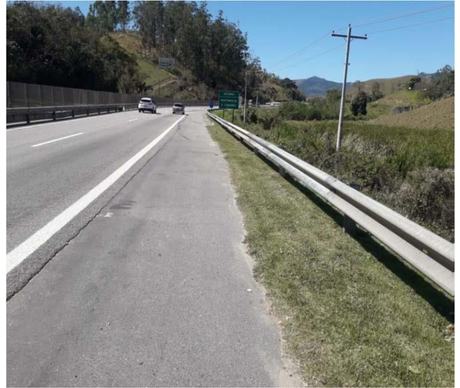
Figura 110 - Dispositivo de Segurança - Km 06+900 Norte
