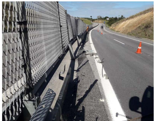
Figura 111 - Dispositivo de Segurança - Km 41+700
