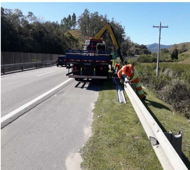
Figura 109 - Dispositivo de Segurança - Km 06+900 Norte
