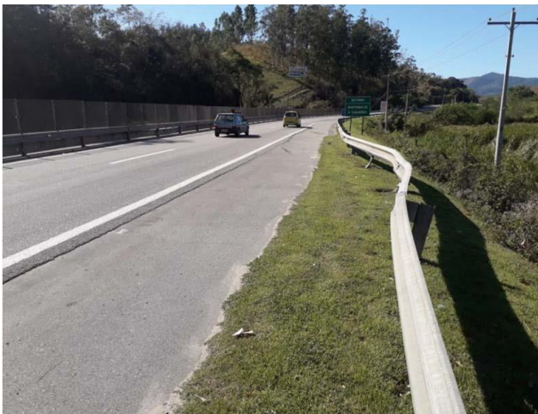
Figura 108 - Dispositivo de Segurança - Km 06+900 Norte
